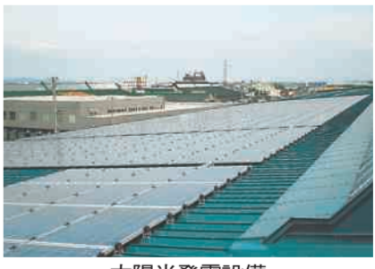
太陽光発電設備
