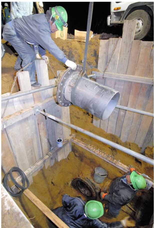
導水管のバイパス工事を行う作業員＝1日午後11時、八戸市坂牛徳良窪
